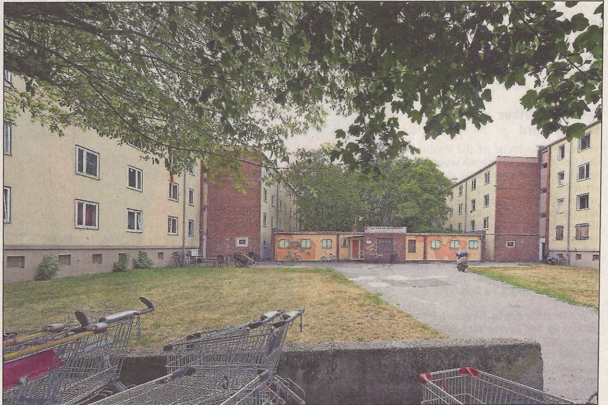
Auf die angekündigte Sanierung der maroden Obdachlosenunterkünfte in der Bayreuther Straße warten die Bewohner seit vielen Jahren vergeblich.
